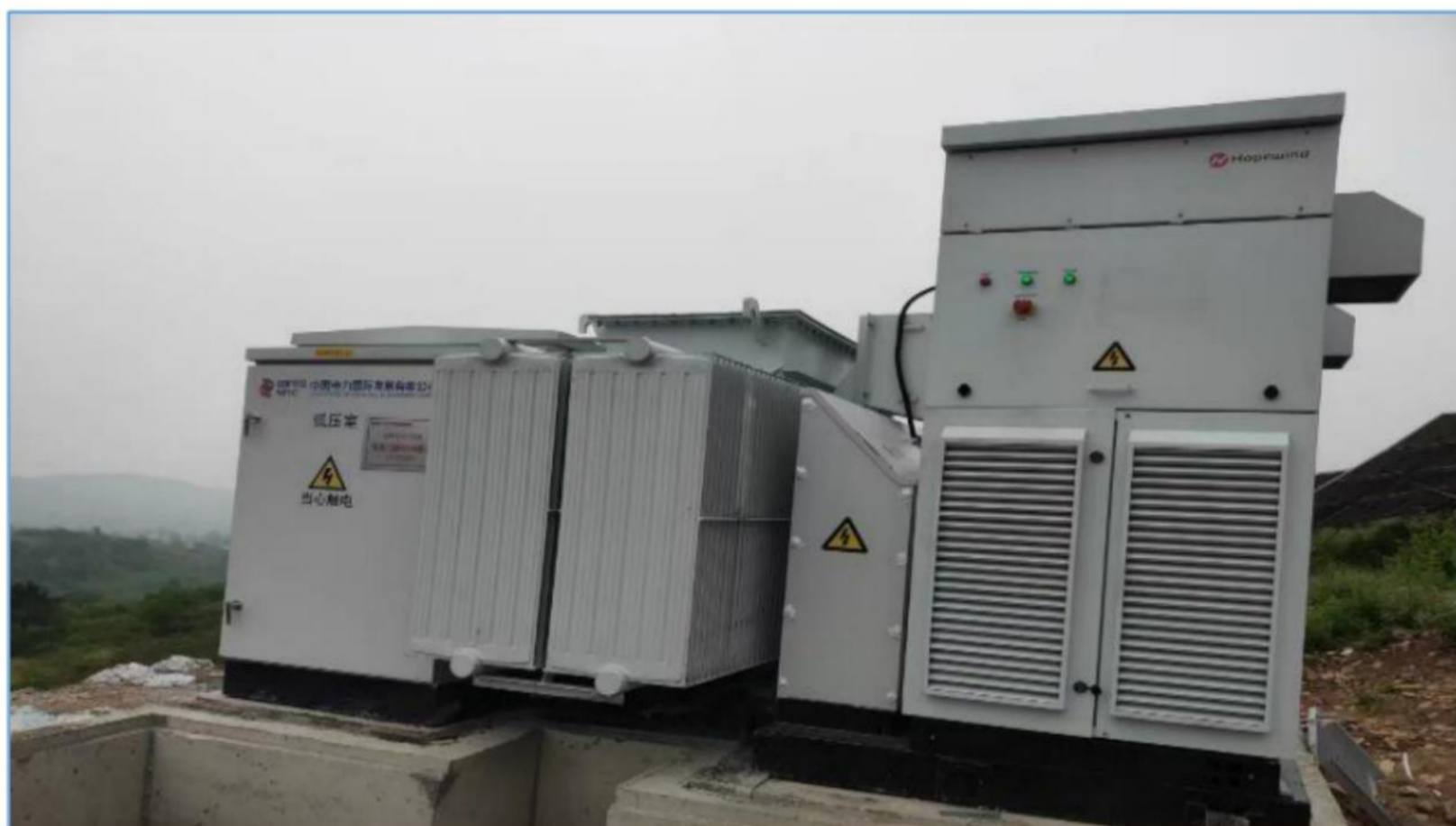
图 7.2.4 集中逆变升压一体机
