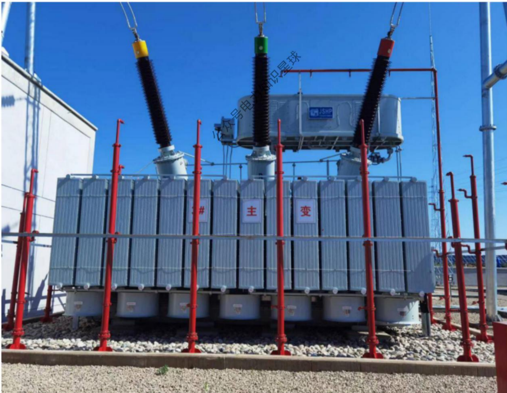
图 9.1.1 升压站主变压器
