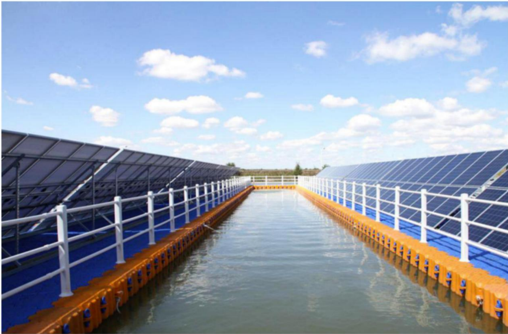
图 4.3 漂浮式水面光伏电站
