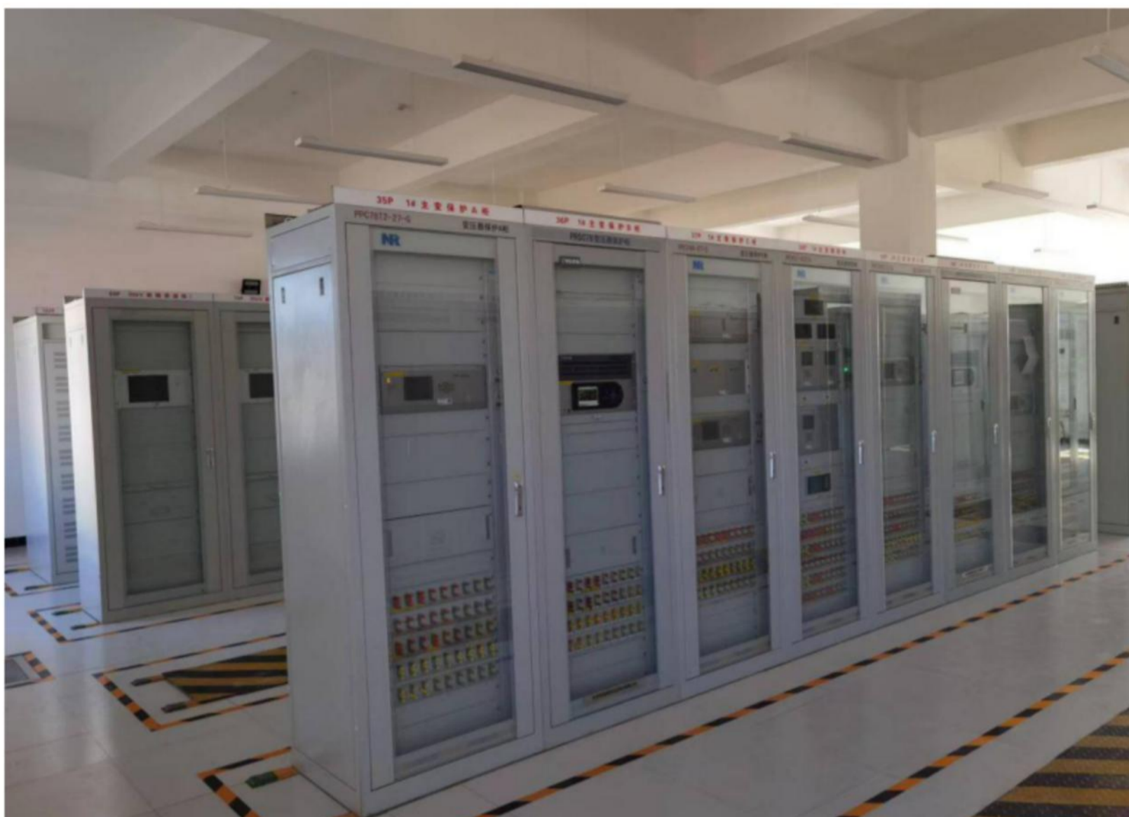
图 9.6.1 综合自动化二次设备屏柜
